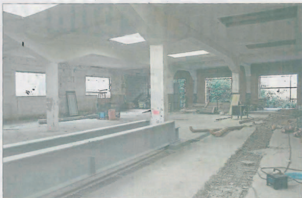
So sieht die Halle von innen aus. In diesem noch leeren Raum soll eine Kinderkrippe entstehen.
