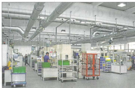
Die dicken Rohre für die Klimatisierung prägen die neue Fertigungshalle.
