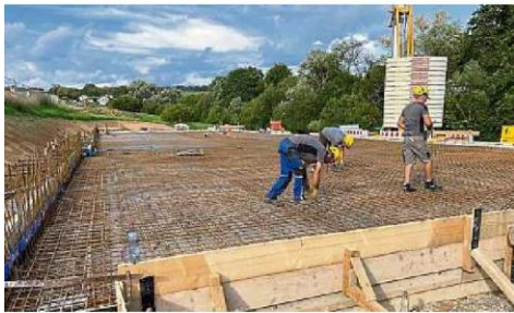
Die Bodenplatte für das neue Feuerwehrgerätehaus ist fast fertig. Trotzdem wurde am Rande der Arbeiten der Spatenstich durchgeführt.
