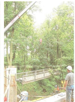
Der Kran hält 6,5 Tonnen Gewicht: Das erste von drei Brückenteilen schwebt über der Kurparkschlucht.
