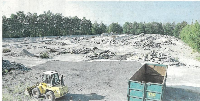
Von den großen Hallen des ehemaligen Betonwerkes Rick ist nichts mehr übrig außer Schutt. Foto: Häring
