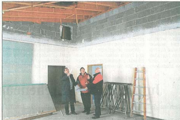
Architekt Willi Hamm, Bürgermeister Thorsten Sprenger und Bauamtsmitarbeiter Reinhard Schäfer (von links) begutachten die Schäden im jetzt offen gelegten Dach. (Foto: Henss)
